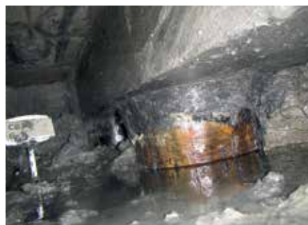
Een van de zeven geïnspecteerde houten palen.
