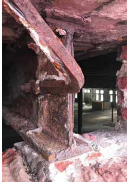
Corrosie stalen liggers en ankerstaven.
